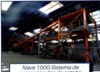
Nave 1000-Sistema de concentrados de estaño
