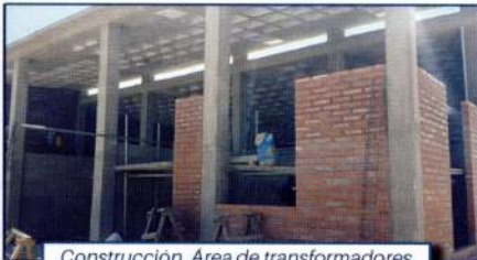
Construcción Area de transformadores y Sala electrica
