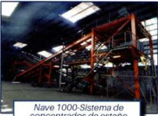
Nave 1000-Sistema de concentrados de estaño
