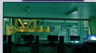
Sala de control de Horno Ausmelt
