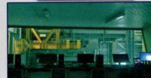
Sala de control de Horno Ausmelt
